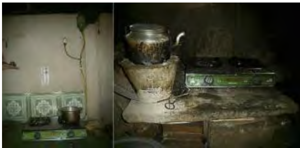
Biogaz (installations de biogaz à petite échelle dans le centre du Vietnam et appareils à biogaz, avec un accent sur l'analyse des gaz de combustion des foyers à biogaz (Roubik et Mazancova, 2019))
