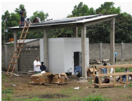
Figure 41. Boîte isolée surmontée d'une petite installation solaire commerciale autonome.
