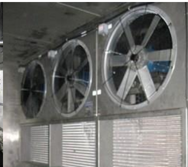
Figure 47. Exemple d'équipement de réfrigération d'un congélateur de grand volume
